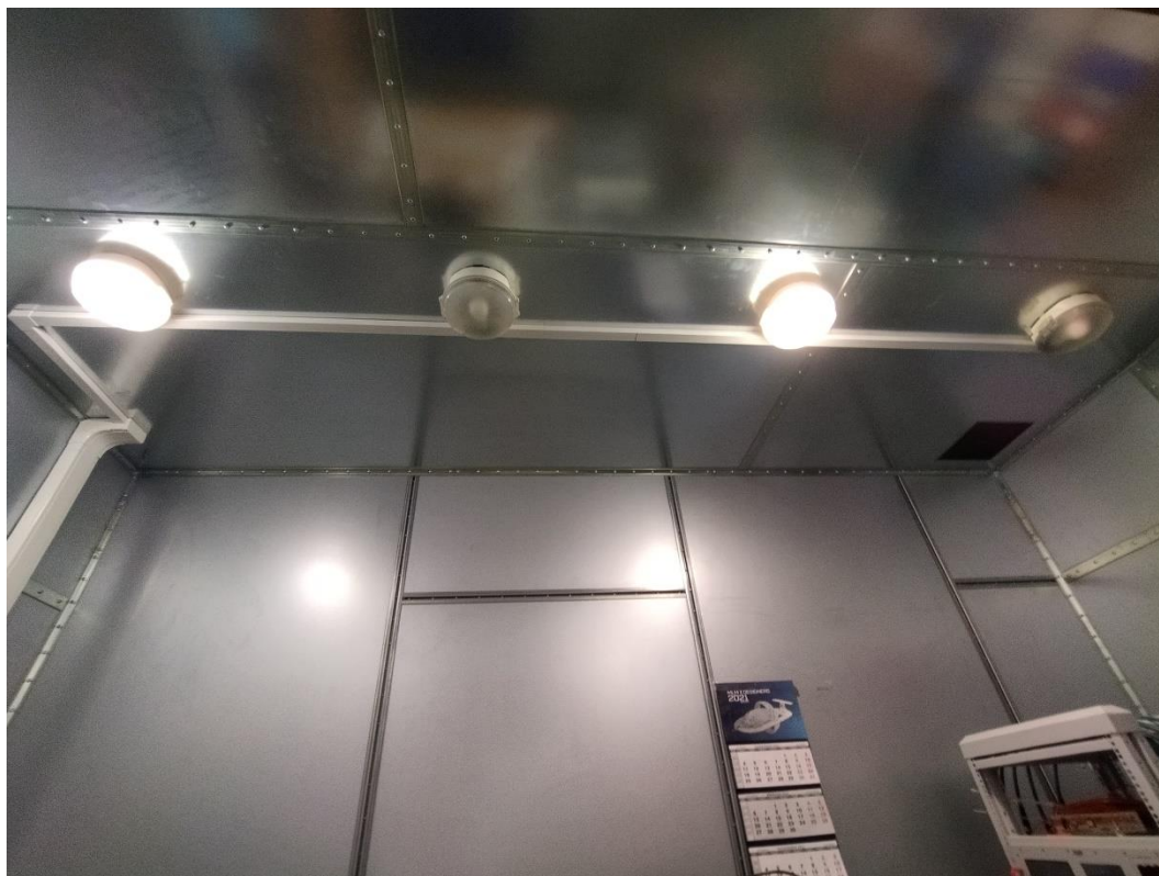
IMG_20211213_091608 Widok na lampy oświetlenia i koryta kablowe przewodów zasilających w pomieszczeniu sterówki komory rewerberacyjnej
