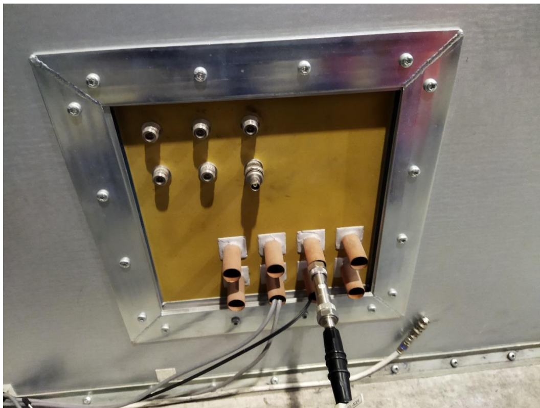
IMG_20211213_092026 Tablica przepustów i gniazd przejściowych w ścianie przedniej, wewnątrz komory rewerberacyjnej
