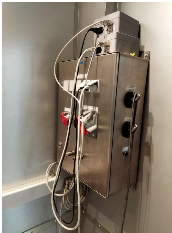
IMG_20211213_090753 Skrzynka zasilająca wewnątrz komory rewerberacyjnej
