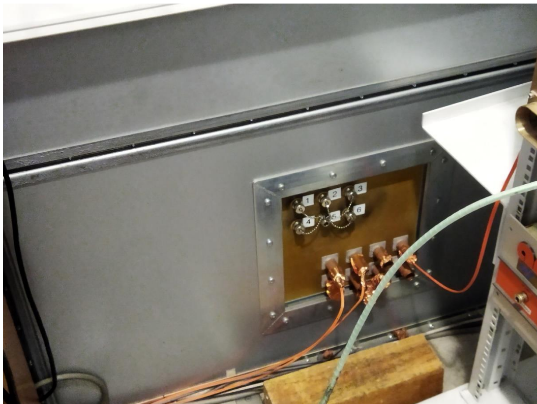
IMG_20211213_091617 Tablica gniazd i przepustów kablowych w ścianie tylnej, wewnątrz sterówki komory rewerberacyjnej
