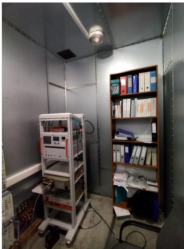
IMG_20211213_091546 Widok na prawą stronę pomieszczenia sterówki komory rewerberacyjnej
